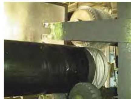
Testa di tubo spazzolata in una stazione di linea automatica / Pipe head inside a cutback automatic station
